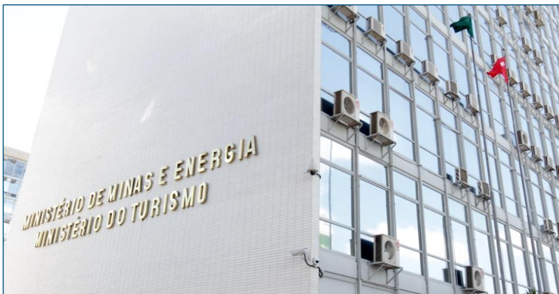
Figura 24 – Fachada de um prédio da Esplanada, com uma diversidade de equipamentos de ar-condicionado instalados
