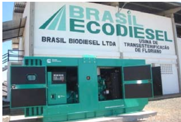
Foto 1 – A Usina de produção de biodiesel e o gerador do teste
