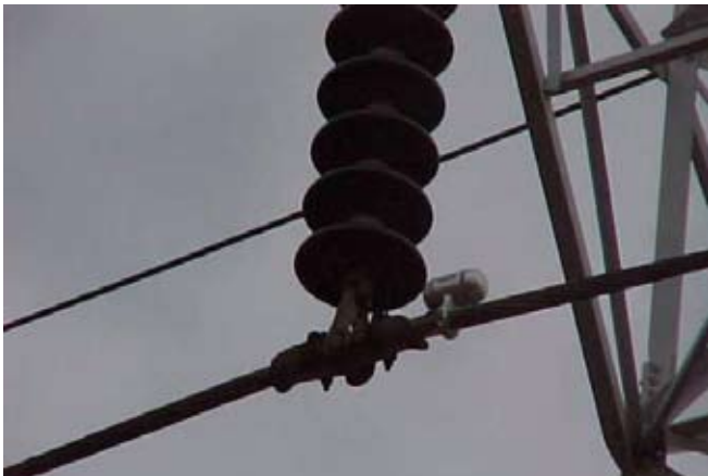
Figura 1 – Medidor de Vibração Eólica (PAVICA), instalado no cabo condutor próximo ao grupo de suspensão.
