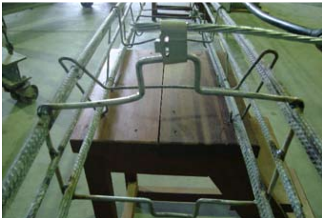
Figura 2. Vista da parte inferior da armação metálica, mostrando a conexão entre o “estribo especial” e os vergalhões.
