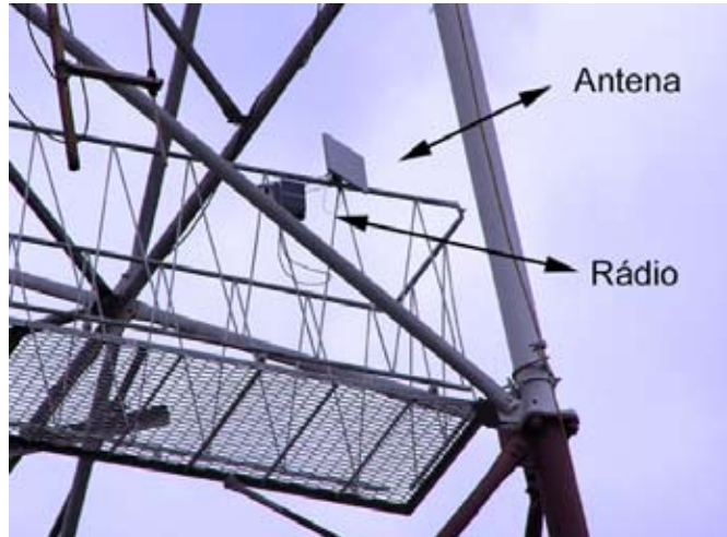
Figura 4: Antena e rádio montados na estrutura de M.O.
