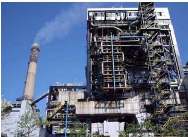
Figura 1. Aspecto externo de uma das caldeiras a carvão mineral da Usina Jorge Lacerda - Tractebel Energia onde desenvolveram-se os trabalhos de pesquisa.
