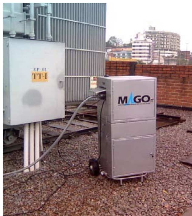
Figura 1 - Analisador de gás em operação [2]
