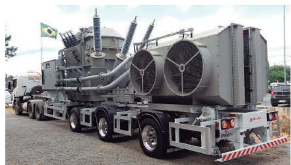
Figura 4. Transformador móvel concluído.
