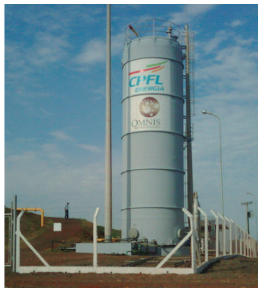
Figura 4. Unidade de dessulfurização
