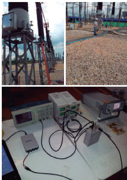
Figura 3. Sensor instalado no TC 702_V do DJ701, telemetria integrada e distância do TC à casa de relés.
