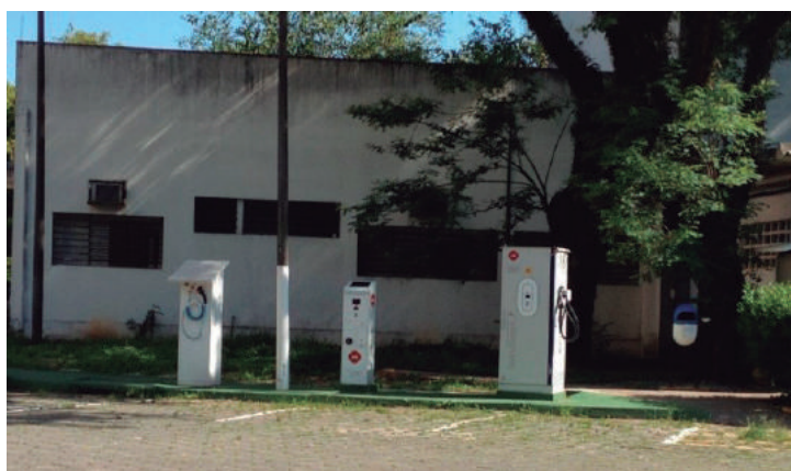
Figura 1. Eletropostos instalados no IEE
