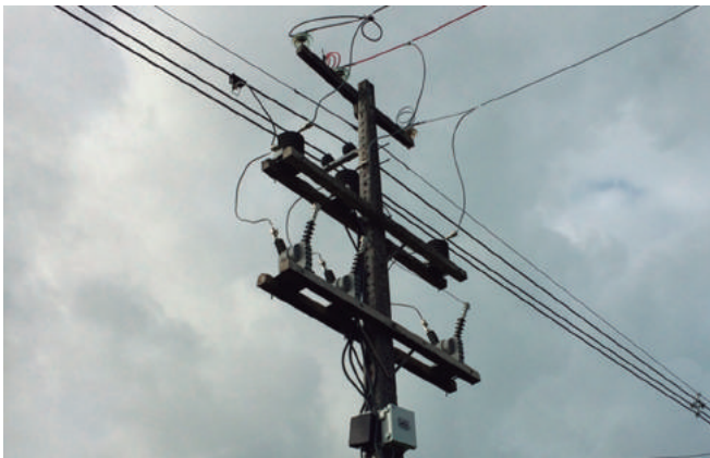
Figura 4. Instalação do monitoramento com o analisador PQube na barra de alimentação do condomínio identificado como (2).
