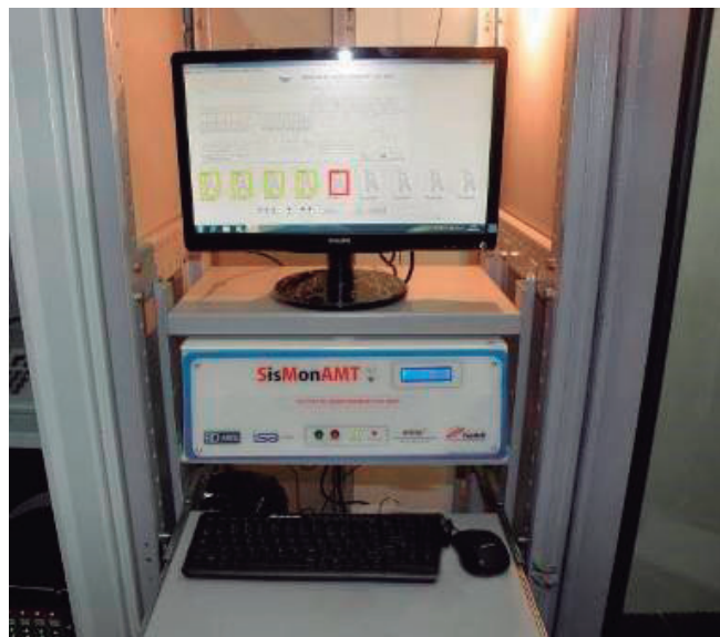
Figura 8. Estação de monitoramento em rack na Sala de Comando da Subestação.
