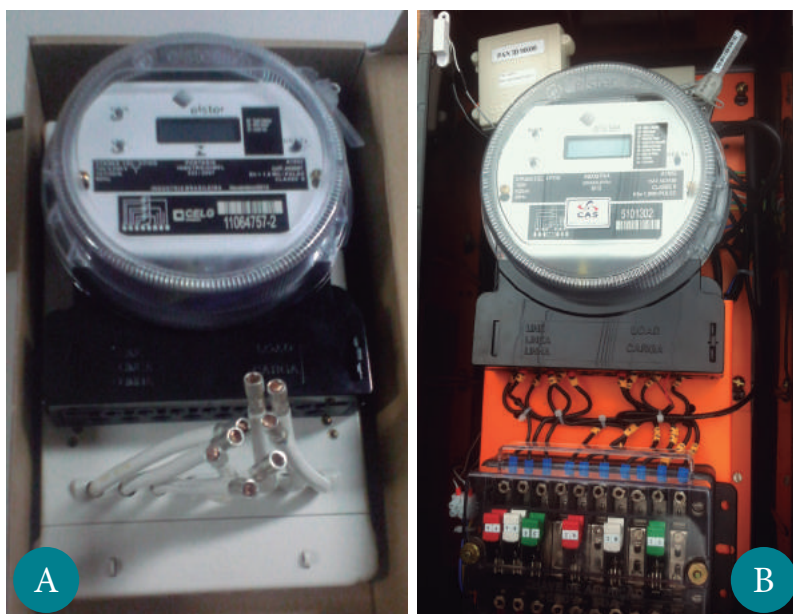
Figura 3. Medidor Trifásico (a) e Conjunto de Medição (b).
