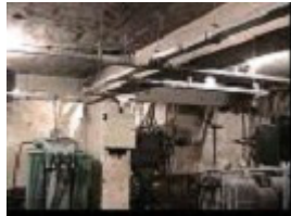
Figura 4. Instalações da CT 1367.
