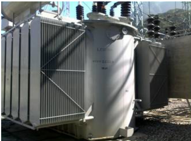
Figura 2 – SE São Conrado – TR 1 – 15/20 MVA – ONAN/ONAF
