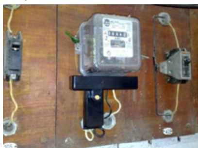
Figura 6 – Detalhe de medidor com conector instalado.
