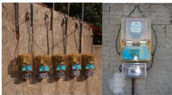
Figura 4: Padrão de entrada dos clientes com caixa travada
