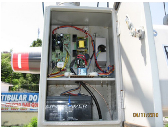
Figura 7. Protótipo instalado na chave tripolar de média tensão.
