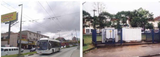
Figura 1. Acima: Rede de alimentação; Abaixo: Estação retificadora do tipo compacta.
