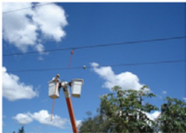
Figura 4 Linha aérea de 138 kV monitorada em Acuruí.
