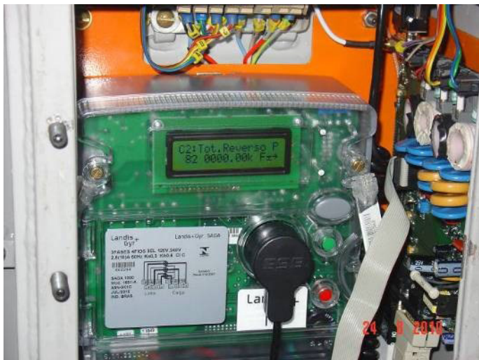
FIGURA 3 – DETALHE DO CIRCUITO ELETRÔNICO INSTALADO NO TRANSFORMADOR COM MEDIÇÃO INTEGRADA
