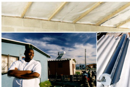
Figura 1. Isolamento do teto e aquecedor solar
