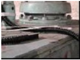
Figura 3. Sensor de ruído em um dos trafos da CT 1367.
