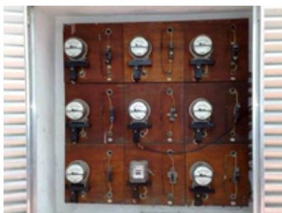
Figura 5– Painel de medidores com os conectores
