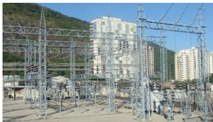
Figura 1 – SE São Conrado – Visão geral
