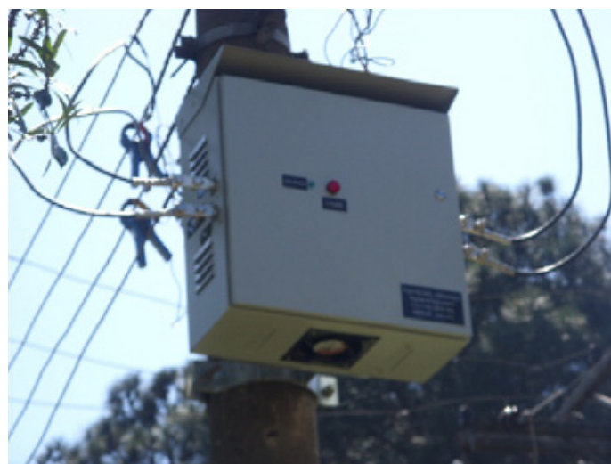
Figura a2 – Foto do RTPBT em Instalado no CT da AES Eletropaulo
