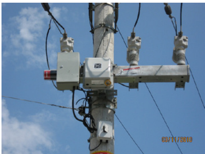
Figura 8. Protótipo instalado em consumidor.
